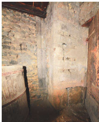
Fig. 80 : Chapelles sud-ouest, détail de la pile rectangulaire à chanfrein de la grande arcade est ; à l'arrière à gauche, base de colonnette engagée d'un arc doubleau séparant deux chapelles. Cliché : L. D'Agostino
