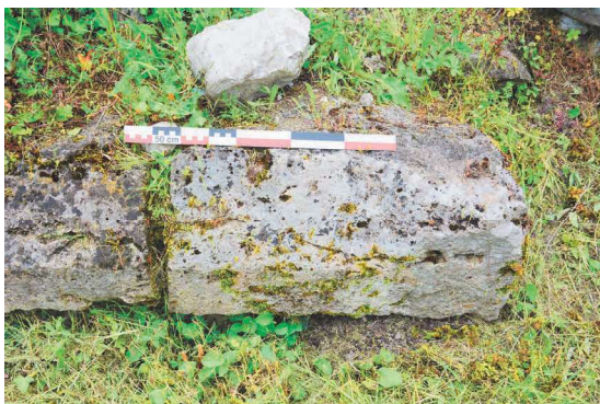
Fig. 43 : Eglise, soubassement chanfreiné et retournement du chanfrein au niveau d'un ancien contrefort disparu. Cliché : E. Chauvin-Desfleurs
