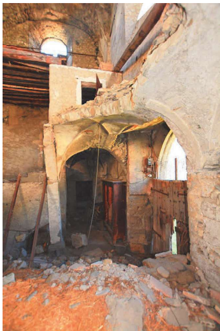
Fig. 29 : Tribune de l'église en partie effondrée. Cliché : L. D'Agostino
