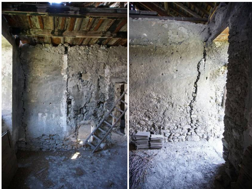
Figure 29 Salle capitulaire, niveau 2, allure des fissures côté est
