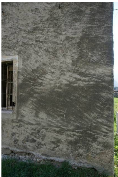
Figure 42 Église, façade ouest des chapelles, faïençage enduit masque potentiellement fissures importantes
