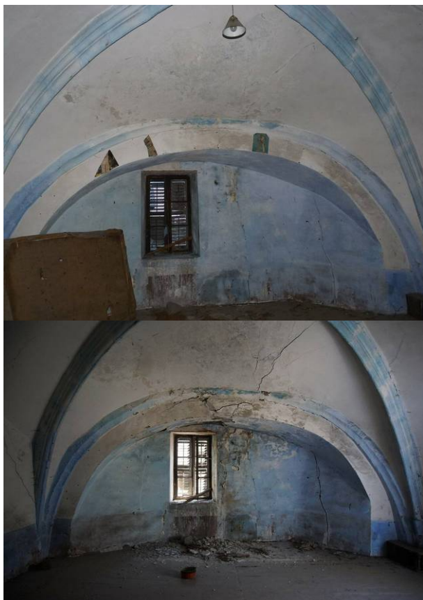
Figure 40 Église, chapelles, chapelle à l'ouest, aggravation des désordres entre 2010 (cliche en haut, Dominique Perron) et 2022 (cliché en bas, Bestrema)
