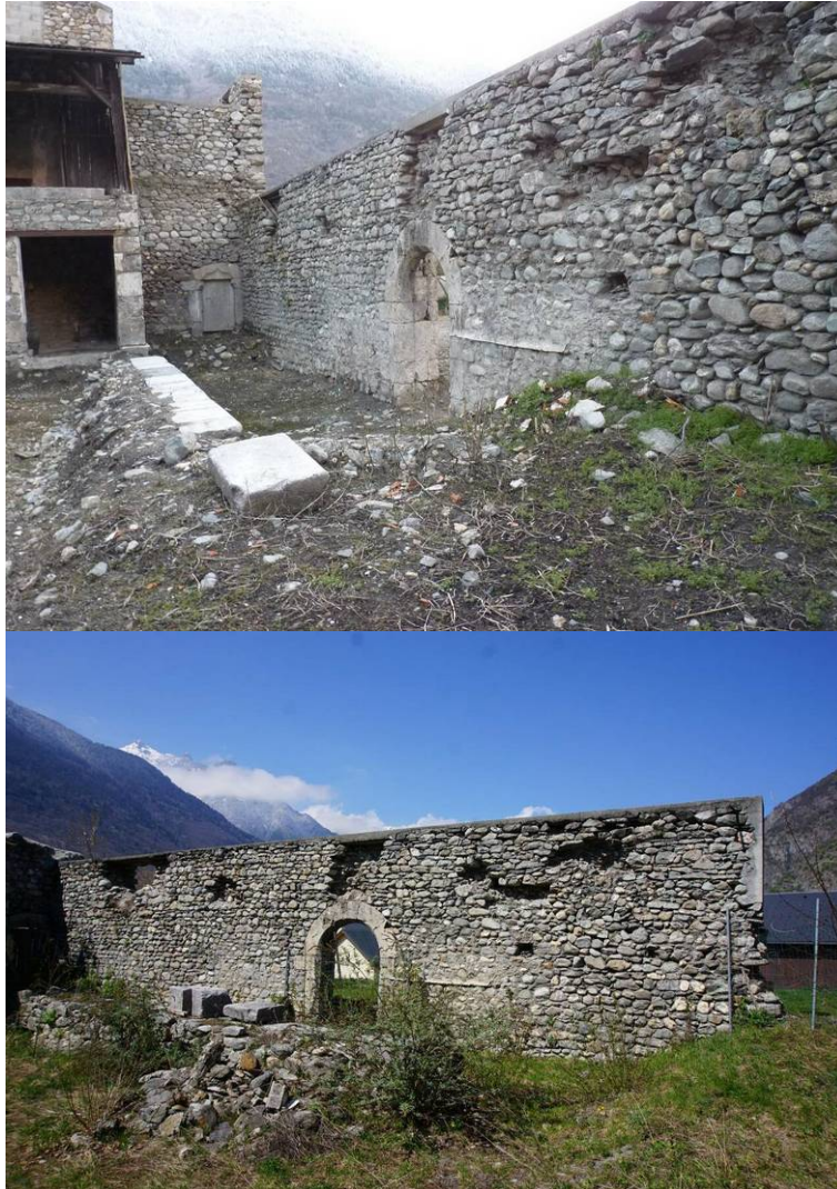
Figure 3 Cloître, mur nord, bouffements et chute parement (cliché Dominique Perron 2010 en haut, Bestrema 2022 en bas)
