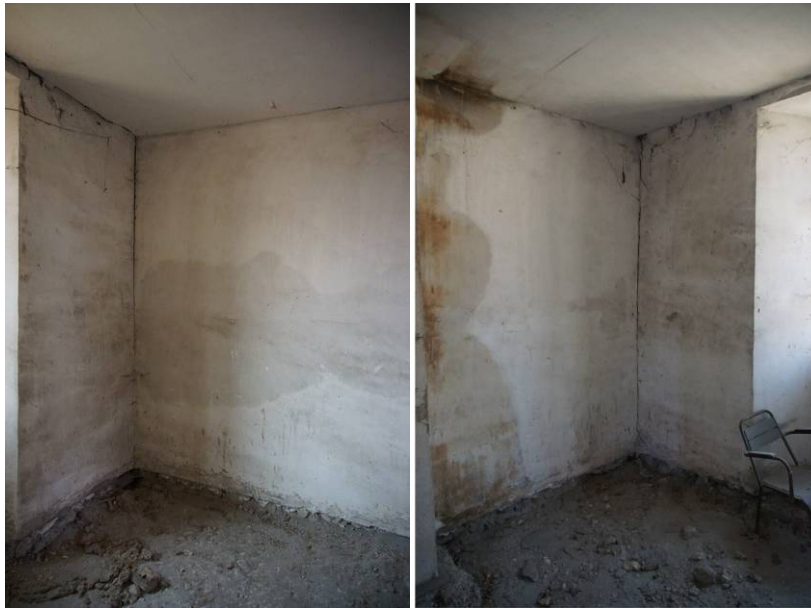
Figure 28 Salle capitulaire, niveau 2, allure des fissures côté ouest
