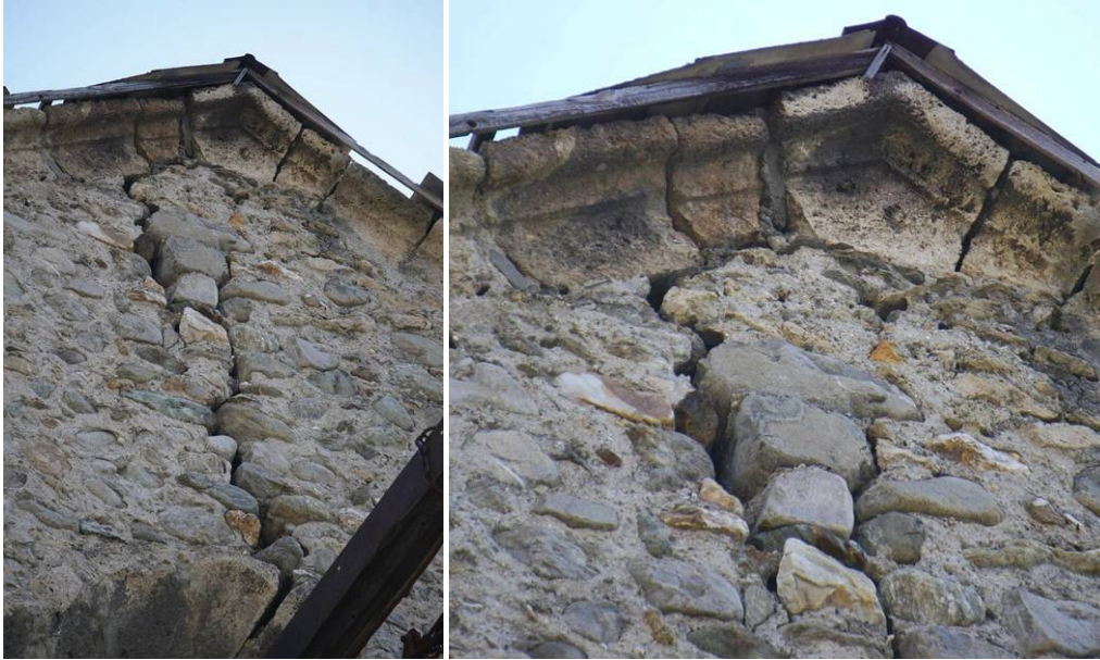
Figure 37 Église, façade occidentale, détail sur la fissure axiale
