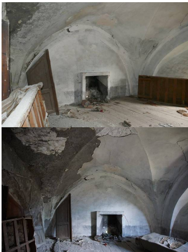
Figure 41 Église, chapelles, chapelle à l'est, aggravation des désordres entre 2021 (cliché en haut, Dominique Perron) et 2022 (cliché en bas, Bestrema)
