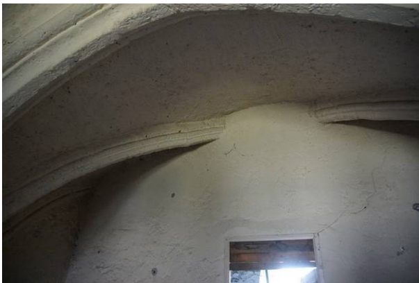
Figure 27 Salle capitulaire, travée nord-ouest, inflexion d'une nervure au niveau d'une cloison
