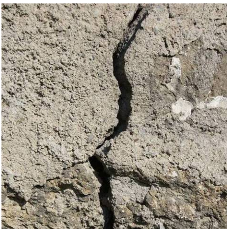
Figure 44 Église, façade sud des chapelles, détail sur la fissure en pied, qui montre un déplacement ~horizontal du pied de mur
