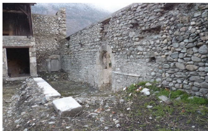
ph4) Mur Nord façade Sud 2010 (D. Perron)
