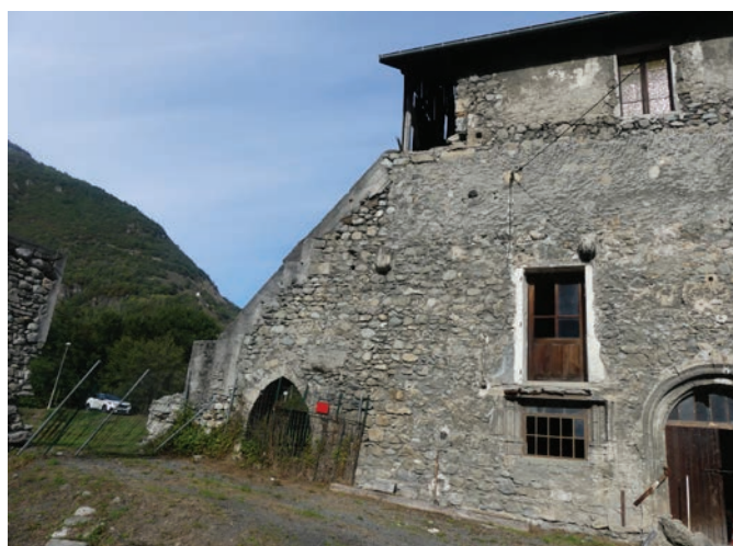
ph41) Mur Nord façade Sud 2019 (D. Perron)
