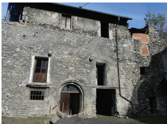
ph40) Mur Nord façade Sud 2019 (D. Perron)
