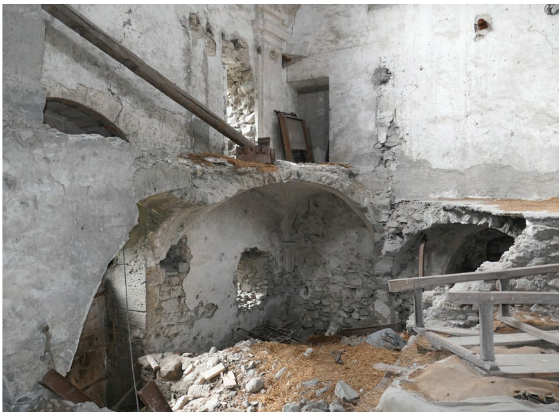
Ph93) vue générale de la tribune effondrée 2021 (D. Perron)
