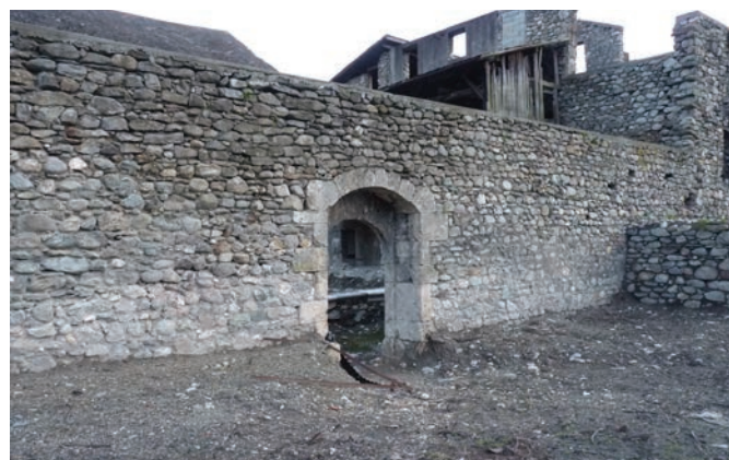
ph5) Mur Nord façade Sud 2010 (D. Perron)
