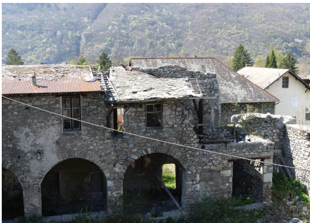
Ph22) Cloître aile Ouest façade Est 2022 (D. Perron) Urgence des travaux de confortement (provisoires ou définitifs)
