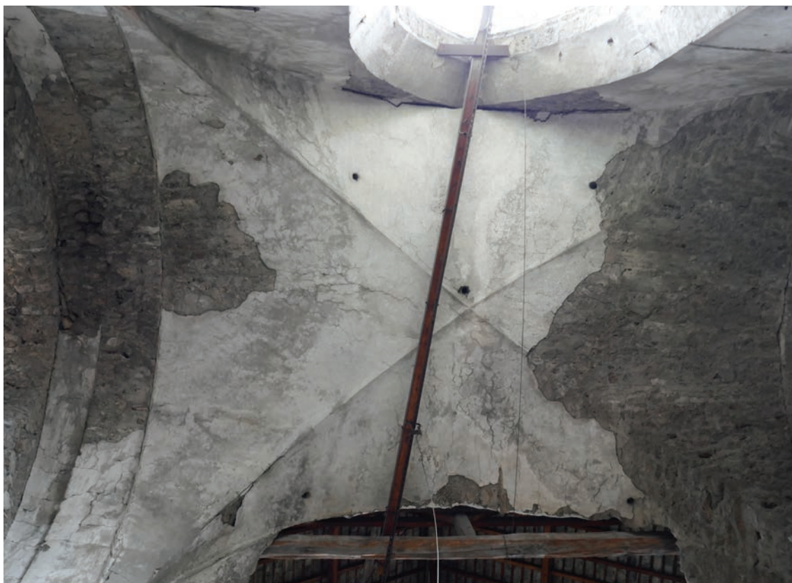
Ph85) voûtes de l'église 2021 (D. Perron)
