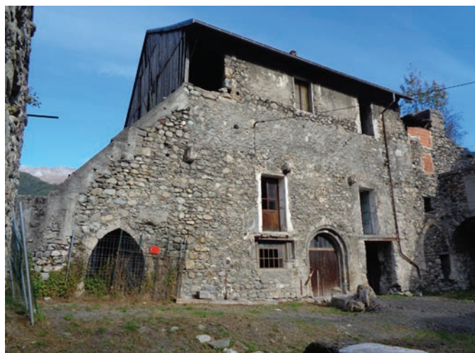
ph39) Mur Nord façade Sud 2010 (D. Perron)
